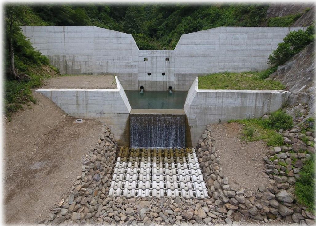
令和元年度工事完成の中股川第3号砂防堰堤（小谷村北小谷戸土地先）
