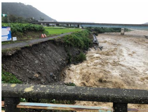
令和元年（2019年）10月台風19号により堤防が欠損した早川（田屋地区）
